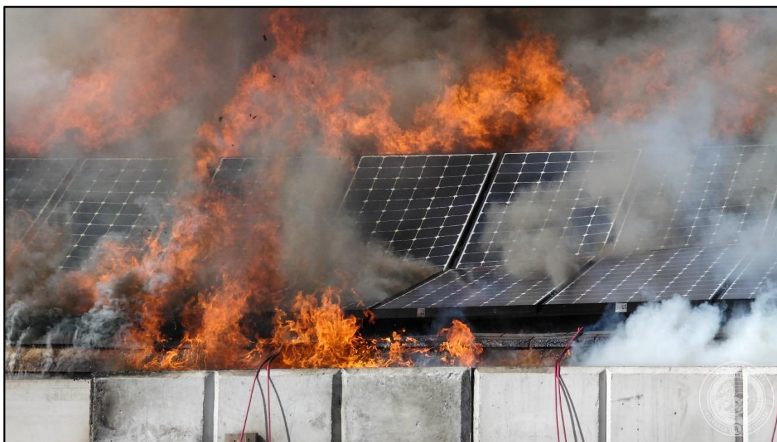
Figura 4 - Acidente envolvendo um sistema fotovoltaico
