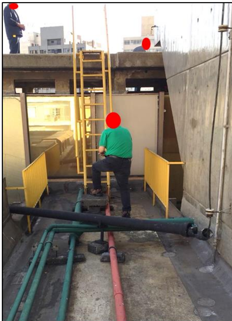
Figura 27 - Tubulações e mangueiras próximas ao piso
