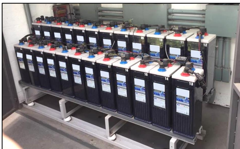
Figura 11 - Exemplo de banco de baterias dedicado a um sistema fotovoltaico
